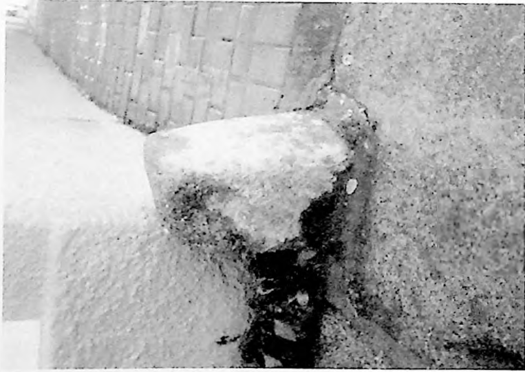
Guardacantón, esquina calle Toledillo con plazoleta de Médico Terrón.
